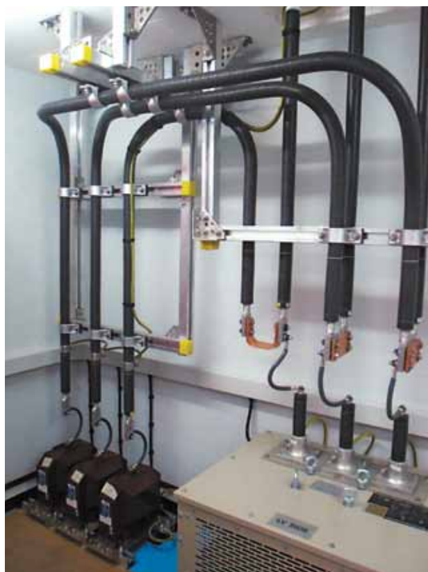
Подключение измерительных трансформаторов к линии токопровода
