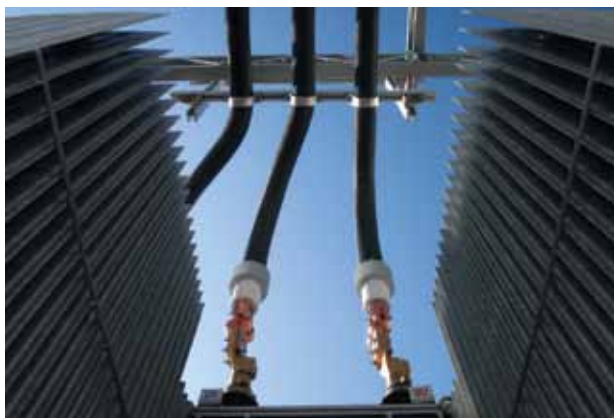
Подключение к трансформатору, наружное исполнение
