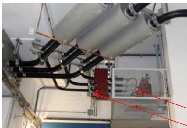
Подключение измерительных трансформаторов
